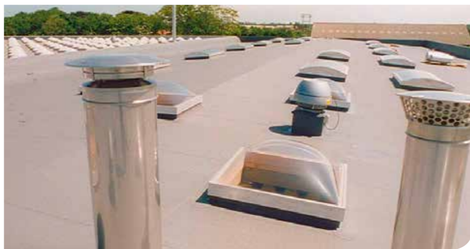
Hvis ikke installasjonene på taket er planlagt riktig, oppstår mange potensielle lekkasjepunkter.
